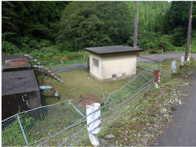
写真1：老朽化した簡易水道設備①
