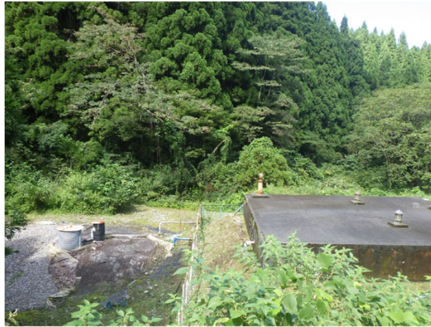
写真2：老朽化した簡易水道設備②
