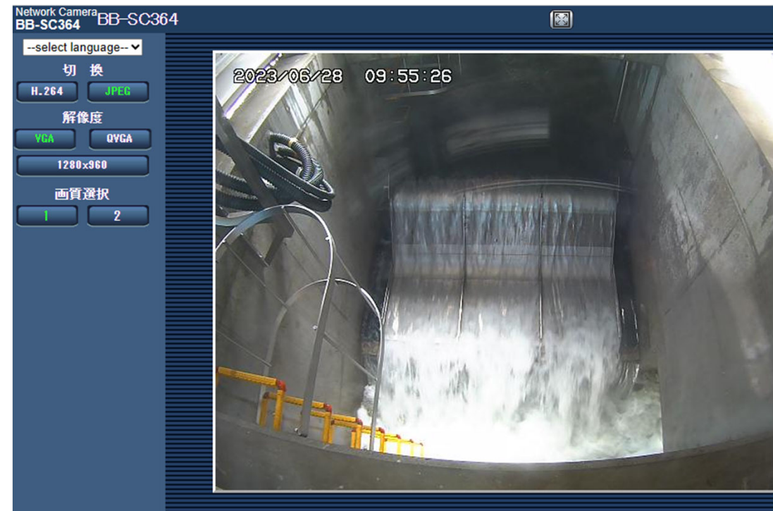
除塵機を監視
